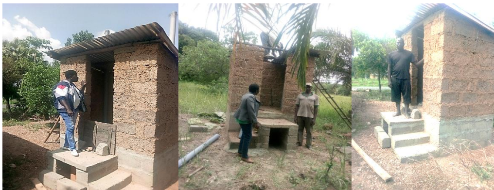
Latrines ECOSAN dans les villages
