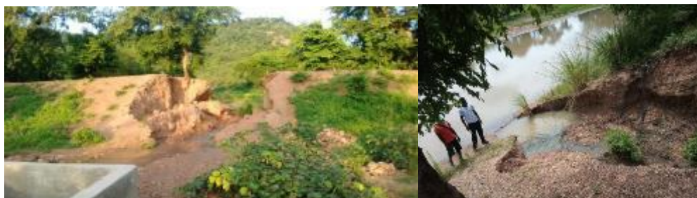
Les ouvrages endommagés par les pluies à Dissani et à Koupakou
