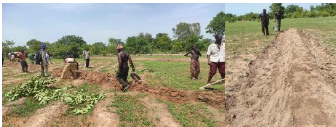
Confession diguette de rétention d'eau
